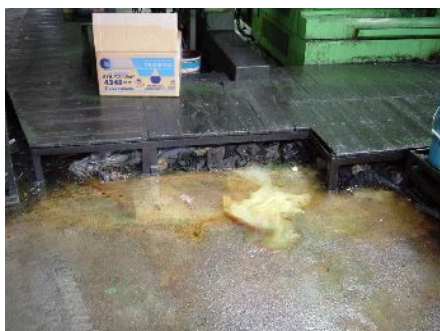
測定器以外(作業場)の汚れの改善
